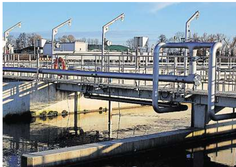
Die Kläranlage des Abwasserzweckverbands Pfattertal. Auf fast 40 Millionen Euro ist der Schuldenberg des Verbands angewachsen. Foto: Archiv
